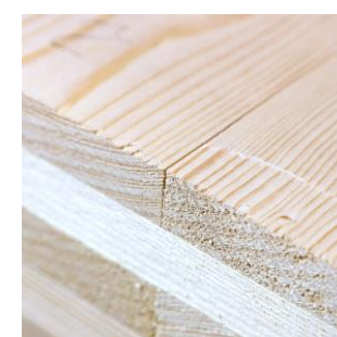
Трещина на пласти
